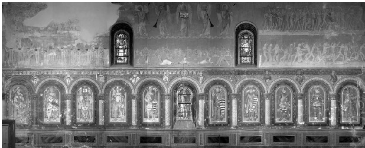
Abb. 4: Gernrode, Stiftskirche St. Cyriakus, Westapsis (Grundlage für die Schadenskartierung für die Restaurierung), oben: Ausgangsbild, gescannt mit Kodak PhotoCD Pro (Auflösung: 4096 x 6144 Pixel), unten: Bildplan der digitalen Abwicklung im Maßstab 1:20 (Montage aus sieben abgewickelten Farbaufnahmen, s. Farbtafel VI, 1)
